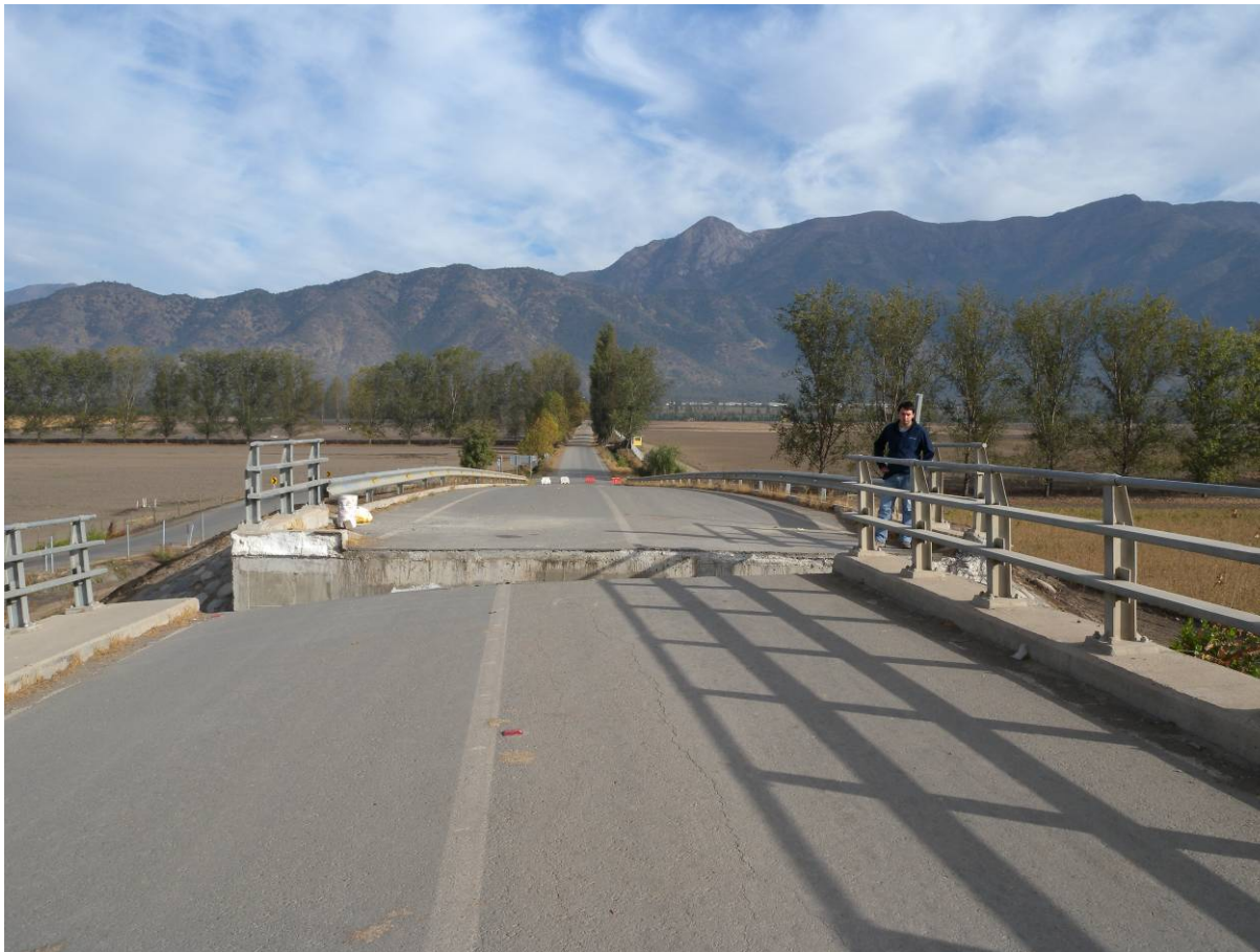
Ruta 5, Paso Inferior de la Merced. Lateral displacement
