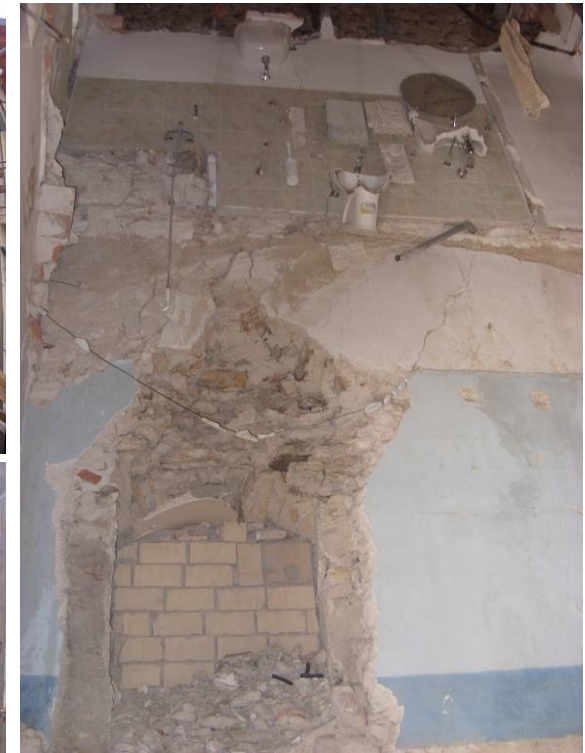
Interni. Collasso degli orizzontamenti
