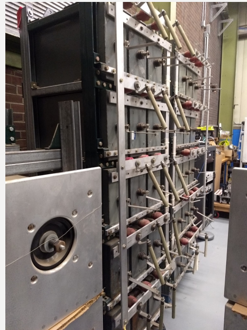
Unistrut (Metal) Racks
