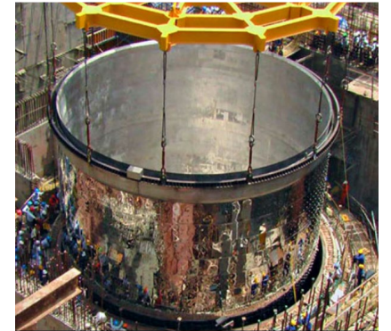
PFBR, 500 MW(e) India, 2024
